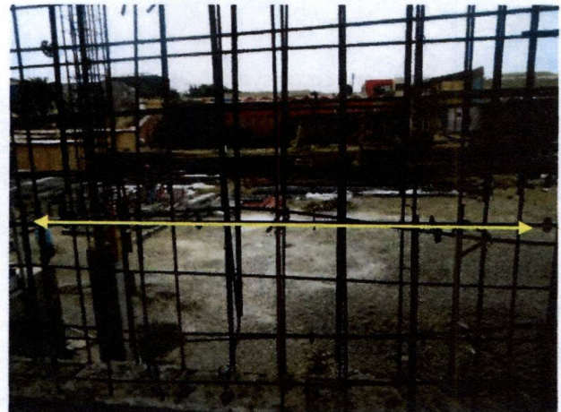
Fotografía N°28, de 28 de marzo de 2014: Elevación de muro del eje N, entre ejes 8 y 9, cuya enfierradura horizontal presentaba deformaciones.
