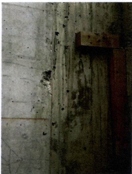
Fotografía N°56, de 28 de marzo de 2014, Vano de ventana no ejecutada en eje 7, entre R y U de la Lámina Tipo A N°03, que contiene la Planta Piso -1 Nivel-3,00, Esc.1:100, de 12 de septiembre de 2012.
