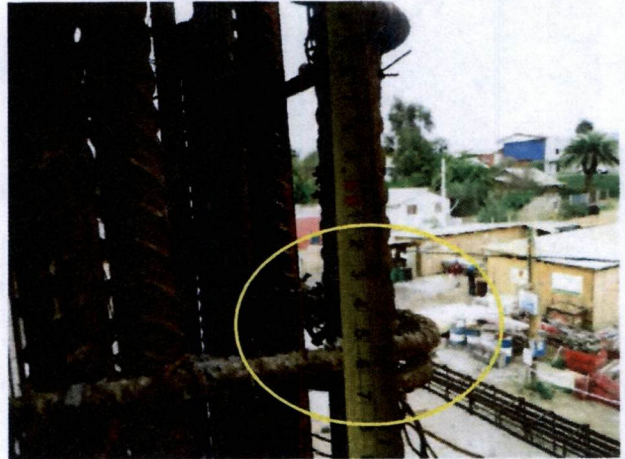
Fotografía N°32, de 14 de mayo de 2014: Pilar en eje 13, de la elevación O, de la Lam. Elevación ejes O y R del plano de estructura CL N°3785-107, de junio de 2012, que identifica el doblaje insuficiente de las armaduras.
