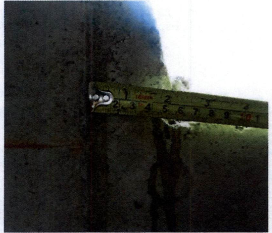
Fotografía N°10, de 28 de marzo de 2014: Encuentro interior de vano de ventana tipo VE2b, en eje R, entre ejes 7 y 8 de Lam. Tipo A N°04, que contiene la Planta Piso 1 Nivel 0,00, Esc. 1:100, de 12 de septiembre de 2012.
