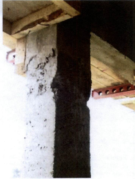
Fotografía N°18, de 28 de marzo de 2014: Desprendimiento de material en pilar ubicado en el encuentro de los ejes O y 8 de la Lam. Tipo A N°4, que contiene la Planta Piso 1 Nivel 0,00, Esc. 1:100, de 12 de septiembre de 2012.
