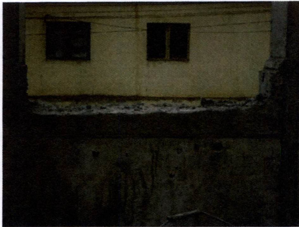
Fotografía N°9, de 28 de marzo de 2014: Vista de la deformación de un vano de ventana tipo VE2, en eje R, entre ejes 11 y 12, de la Lam. Tipo A N°05, que contiene la Planta P. 2 Nivel 3,00, Esc.1:100, de 12 de septiembre de 2012.
