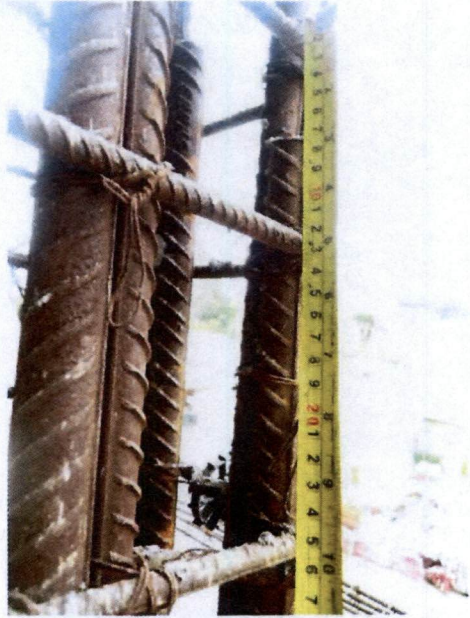
Fotografía N°34, de 16 de mayo de 2014: Enfierraduras eje 13 de la elevación Eje O de la Lam. de Elev. Ejes O y R. contenida en Plano N° CL 3785-107. de junio de 2012.
