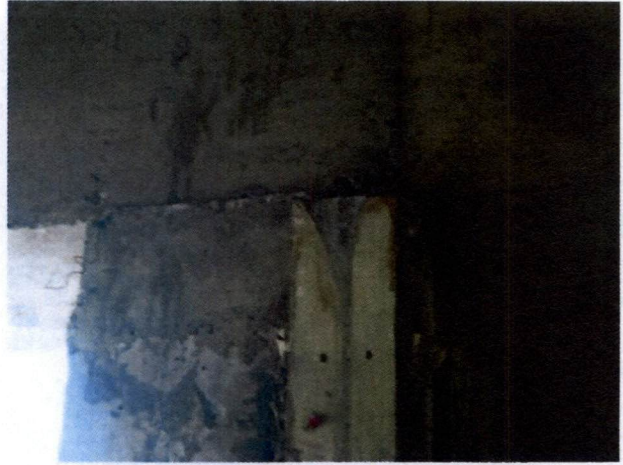
Fotografía N°8, de 16 de mayo de 2014: Pérdida de geometría en encuentro de pilar y viga, entre ejes R y 7 de la Planta de Estructura 1 er. piso de la Lam. N°CL 3785-105, que contiene la Planta de Cielo, Esc. 1:75, de abril de 2012.
