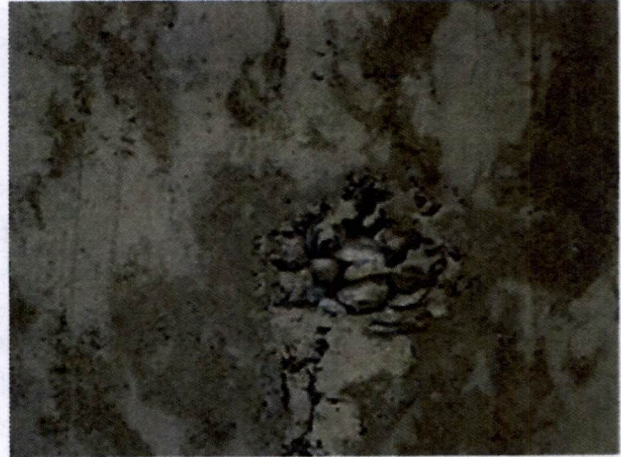
Fotografía N°4, de 28 de marzo de 2014: Detalle muro entre ejes Ñ y 13 de la Lam. Tipo A N°03 que contiene la Planta P.-1 nivel -3,00, Esc.1:100, de 12 de septiembre de 2012, que presenta nido de piedras.
