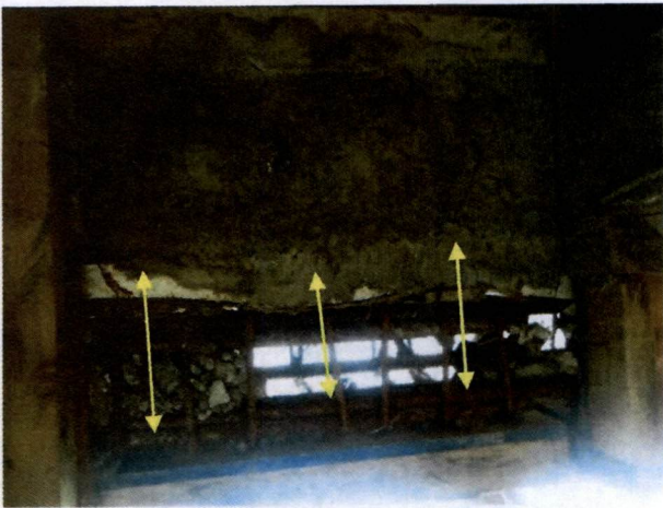
Fotografía N°31, de 14 de mayo de 2014: Viga eje O, entre ejes 6 y 7 de la Lam. A N°02, que contiene la Planta P.-2 Nivel -5,50, Esc.1:100, de 12 de septiembre de 2012, con estribos colocados a distintos distanciamientos y la eventual falta de monolitismo del hormigón, al tener distintas edades y pérdida de geometría.
