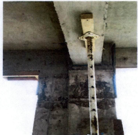
Fotografía N° 12, de 28 de marzo de 2014: Vista de la deformación de un elemento vertical en eje R, entre los ejes 8 y 9, de la Lam. Tipo A N°4, que contiene la Planta P.1 Nivel 0,00, Esc. 1:100, de 12 de septiembre de 2012.
