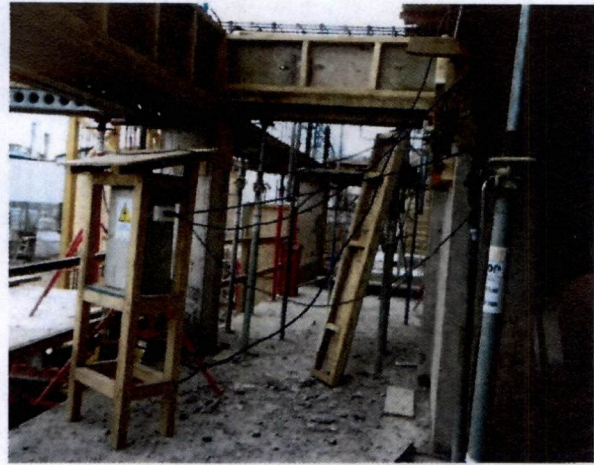
Fotografía N°63, de 14 de mayo de 2014: Cables obstaculizando el libre tránsito sin resguardo ni señalización, entre los ejes 10-11 y O-P, de la Lam.A N°04, que contiene la Planta Piso -1 nivel -3,00.
