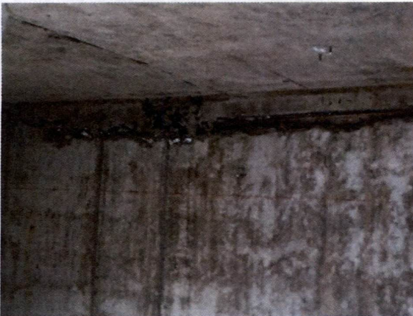
Fotografía N°26, de 16 de mayo de 2014: Enfierradura a la vista en parte superior de muro de eje 6, entre ejes O y P, de la Lam. A N°04, que contiene la planta P.1 Nivel 0,00, Esc.1:100, de 12 de septiembre de 2012.
