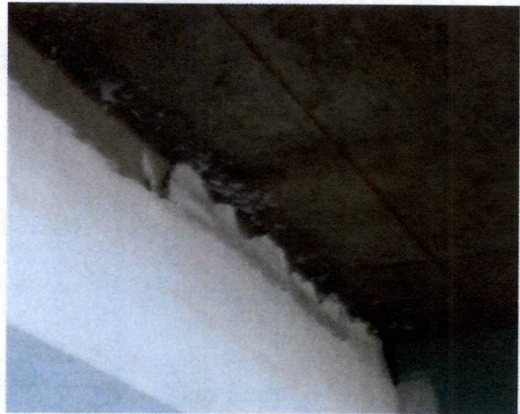
Fotografía N°44, de 8 de agosto de 2014: Viga eje Q, entre ejes 9 y 10 de la Lam. A N°5, Planta P.2 Nivel 3,00, Esc.1:100, de 12 de septiembre de 2012.
