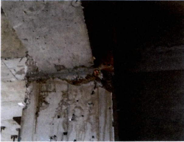
Fotografía N°21, de 28 de marzo de 2014: Desprendimiento de material en pilar ubicado en el encuentro de los ejes P y 8 de la Lam. Tipo A N°4, que contiene la Planta P.1 Nivel 0,00, Esc.1:100, de 12 de septiembre de 2012. Asimismo, se aprecian residuos del material utilizado para el moldaje.
