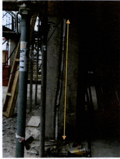
Fotografía N°14, de 14 de mayo de 2014: Ilustración de pilar en encuentro de ejes Ñ-O y 10-11, de la Lam. A N°03, que contiene la Planta P.-1 Nivel -3,00, Esc.1:100, de 12 de septiembre de 2012, que denota la falla en la junta.
