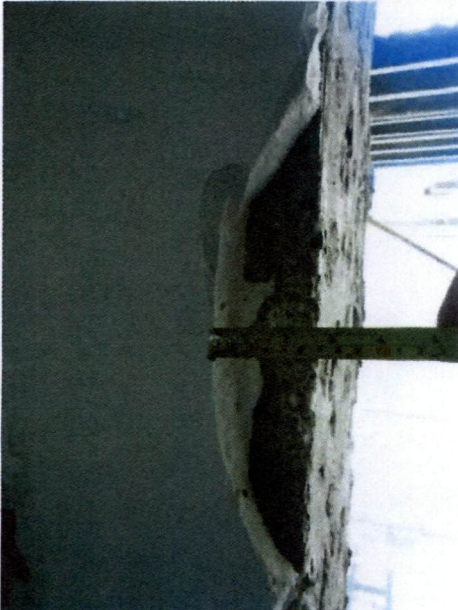
Fotografía N°45, de 8 de agosto de 2014: Muro eje R, entre ejes 13 y 14 de la Lam. A N°05, Planta P.2 Nivel 3,00, Esc.1:100, de 12 de septiembre de 2012.
