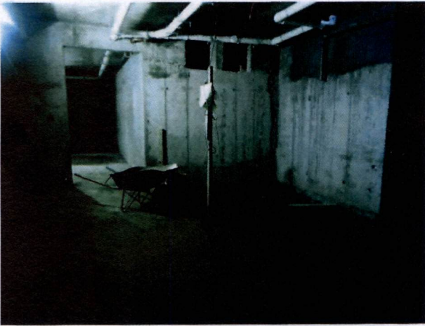
Fotografía N°64, de 14 de mayo de 2014: Excavación sin medidas de seguridad y señalización insuficiente, ubicada entre los ejes P-Q y 13-14, de la Lámina Tipo A N°02, que contiene la Planta Piso -2 Nivel -5,50.
