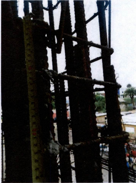
Fotografía N°33, de 16 de mayo de 2014: Enfierraduras eje 13 de la elevación Eje O de la Lam. de Elev. Ejes O y R. contenida en Plano N°CL 3785-107. de junio de 2012.
