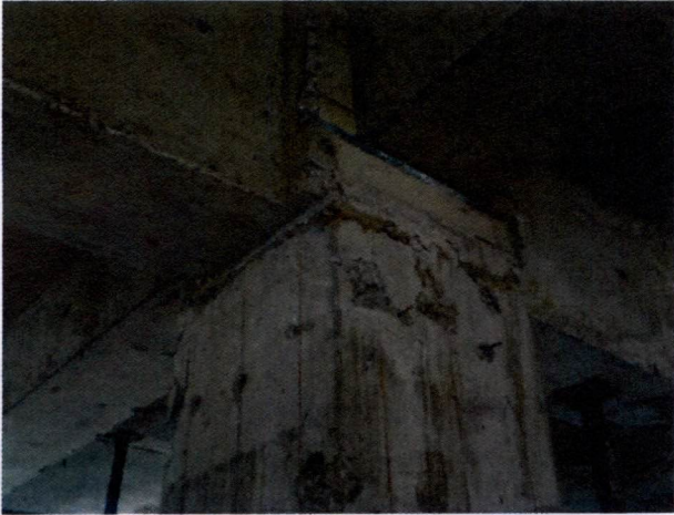
Fotografía N°7, de 28 de marzo de 2014: Pérdida de geometría en encuentro de pilar y viga, y presencia de restos de moldajes entre los ejes Q y 9 de la Lam. Tipo A N°4, que contiene la Planta P.1 Nivel 0,00, Esc.1:100, de 12 de septiembre de 2012.
