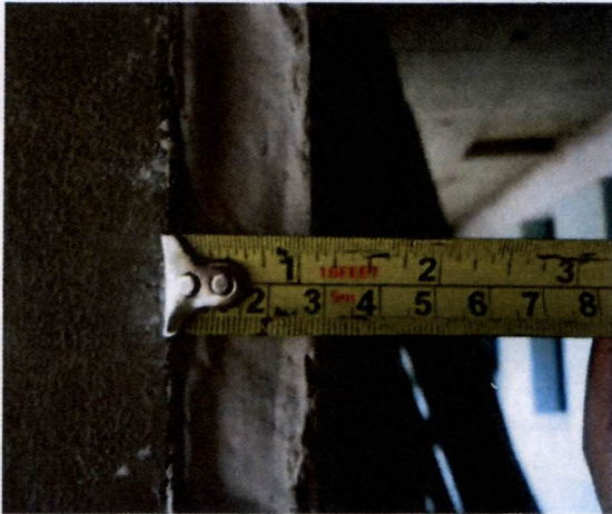
Fotografía N°39, de 14 de mayo de 2014, espesor de recubrimiento superior a 2,5 cm. en muro sector norponiente de eje O, entre ejes 13 y 14 de la Lam A N°03, que contiene Planta Piso -1 Nivel -3,00, Esc.1:100, de 12 de sept. de 2012.
