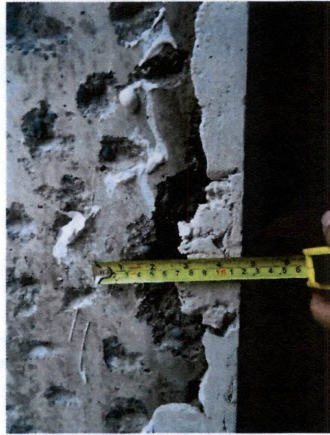
Fotografía N°20, de 14 de mayo de 2014: Desprendimiento en esquina de pilar eje 14, entre ejes Q y R de la Lam A N°03, que contiene la Planta P.-1 Nivel -3,00, Esc. 1:100, de 12 de septiembre de 2012.
