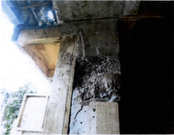
Fotografía N°24, de 14 de mayo de 2014: Enfierradura y desprendimiento de material en eje O, entre ejes 6 y 7 de la Lam. A N°02, que contiene la Planta P.-2 Nivel -5,50, Esc.1:100, de 12 de septiembre de 2012.
