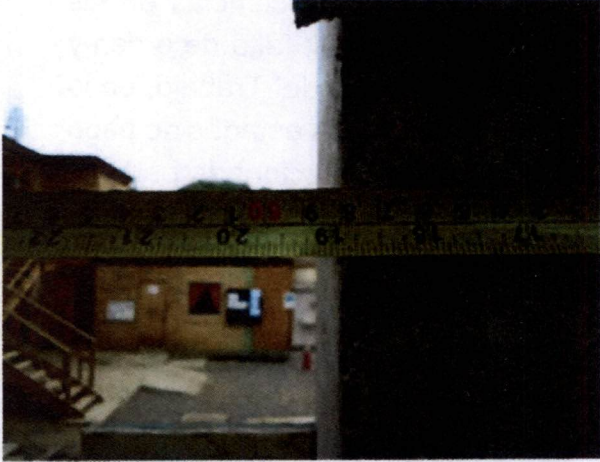
Fotografía N°1, de 28 de marzo de 2014: Pilar que presenta nidos de piedra en encuentro de ejes 14-N de la Lam. A N°03 que contiene la Planta P.-1 Nivel -3,00, Esc.1:100, de 12 de septiembre de 2012.
