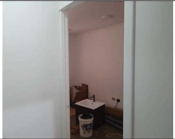
Fotografía N°13, de 11 de febrero de 2020: Acceso a recintos no informados en la planimetría del 2° nivel, del permiso de edificación N°11, de 2019.
