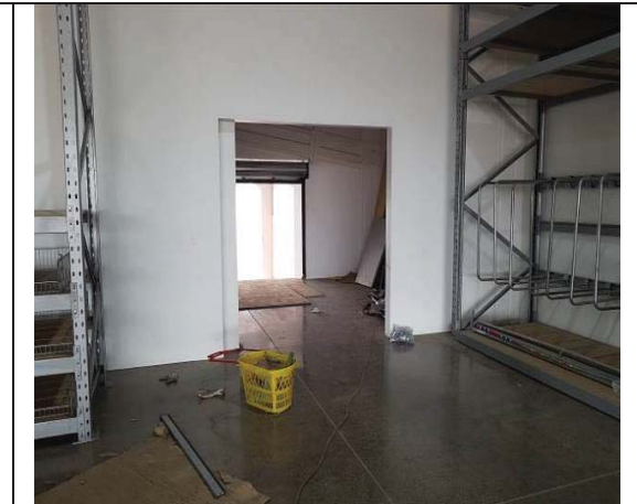
Fotografía N°15, de 11 de febrero de 2020: Acceso a recintos no informados en la planimetría del 2° nivel, del permiso de edificación N°11, de 2019
