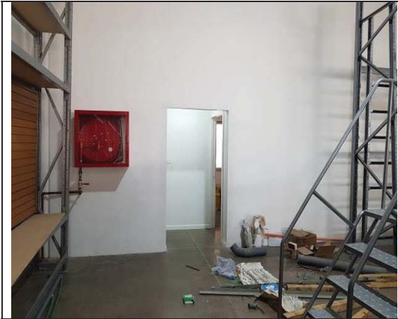
Fotografía N°12, de 11 de febrero de 2020: Acceso a recintos no informados en la planimetría del 2° nivel, del permiso de edificación N°11, de 2019.
