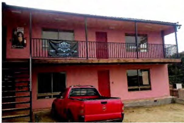
Fotografía N°15 -PE N°115/14, Ortuzar N°698, locales comerciales con modificaciones sin regularizar.
