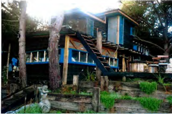
Fotografía N°7 -PE N°137/14, Camino Cáhuil N°4551, loteo de 15 construcciones, cabaña presenta una modificación de segundo piso no regularizada.
