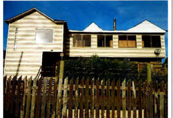
Fotografía N°4 - PE N°19/14, Manuel de Jesús N°365, vivienda no concuerda con fachada, modificaciones de superficie.
